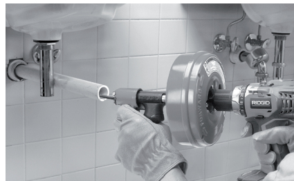
Figura 7 – Esempio di prolungamento dello scarico fino a un massimo di 4" (100 mm) dall'entrata dello scarico
